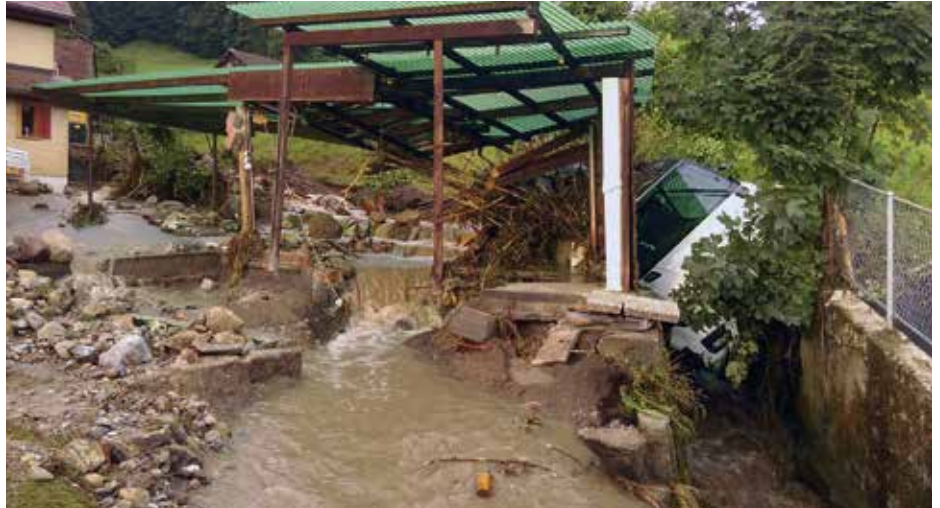
Hochwasserschäden Sihleggbach 2016, Wollerau
